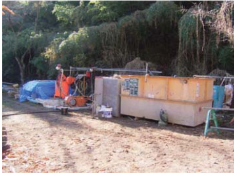
プラント設備
