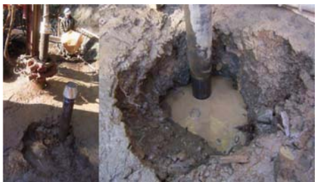
削孔状況(孔壁崩壊)
