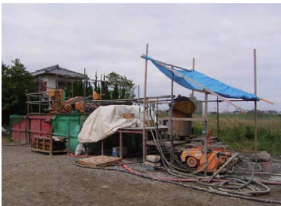
プラント設備
