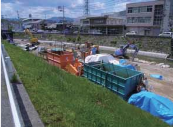
プラント設備
