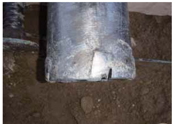
転石により破損した先端ビット
