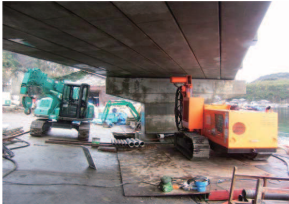
機械配置状況
