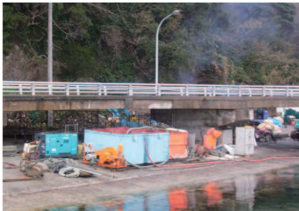
プラント設備
