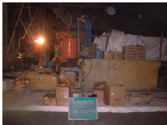
プラント設備
