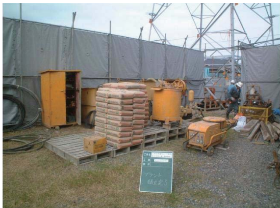
プラント設備
