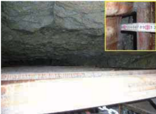
横矢板背面の空隙
