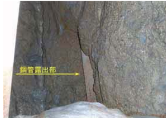
マイクロパイル鋼管露出
