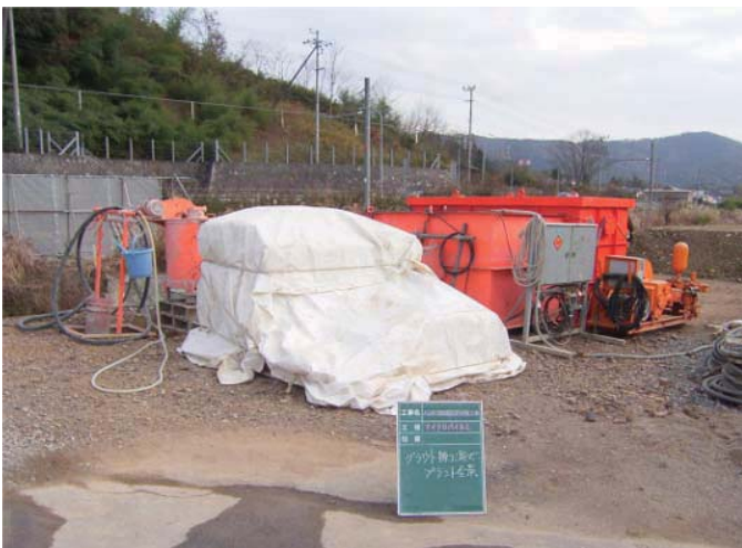
プラント設備
