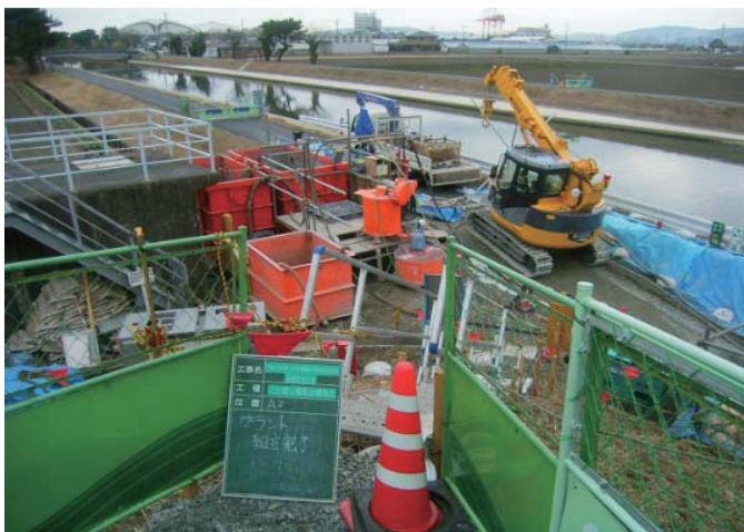
プラント設備
