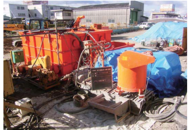
プラント設備
