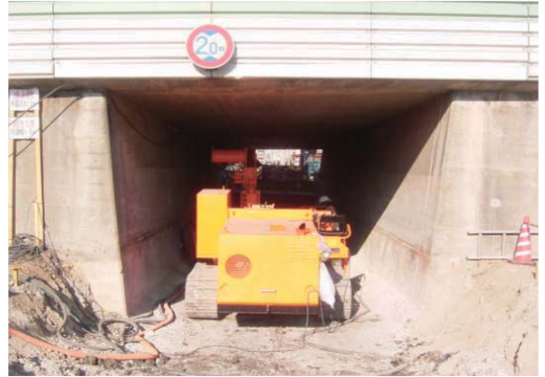
機械配置状況
