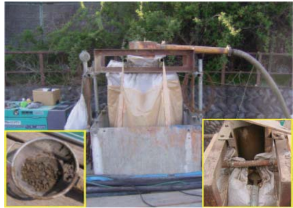
削孔スライム回収設備
