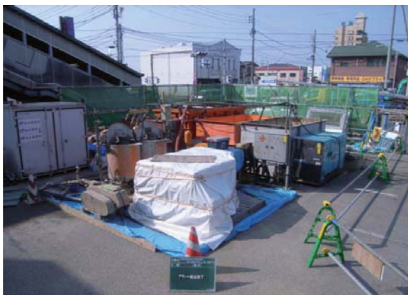
プラント設備
