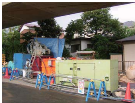
プラント設備
