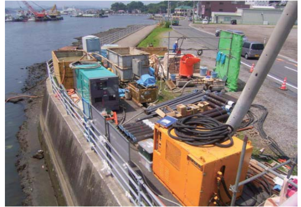
プラント設備
