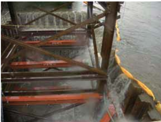
河川増水(締切内への流水)
