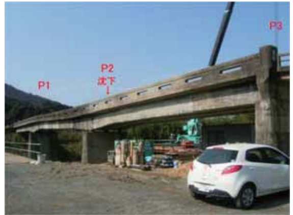
P2橋脚沈下状況
