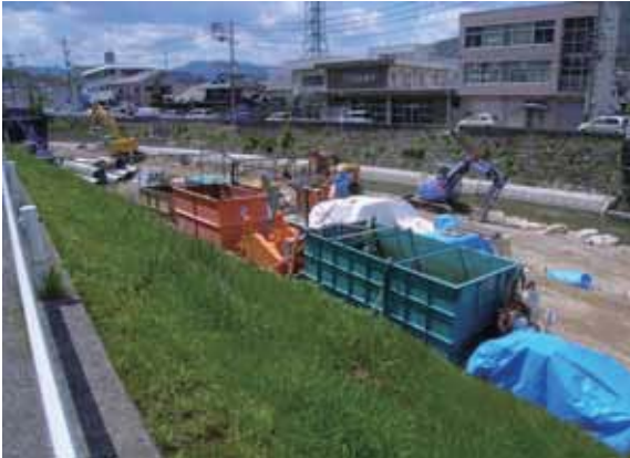
プラント設備
