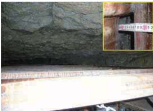
横矢板背面の空隙
