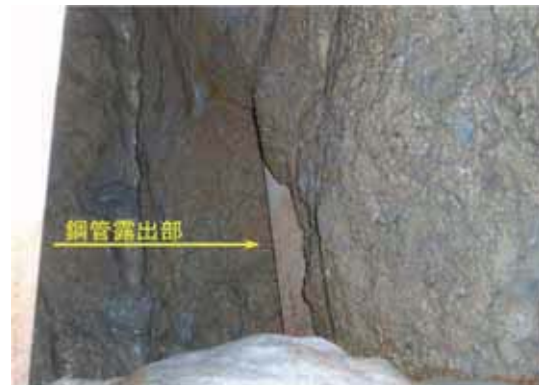
マイクロパイル鋼管露出
