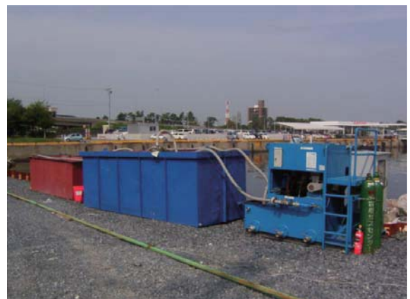
濁水プラント
