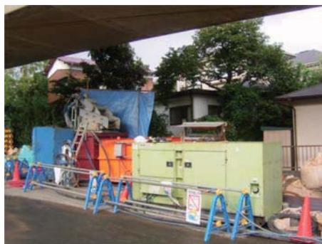
プラント設備
