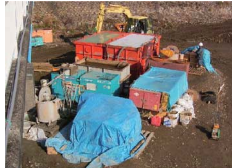
プラント設備
