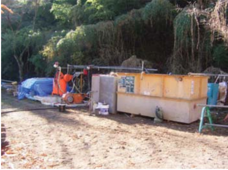
プラント設備
