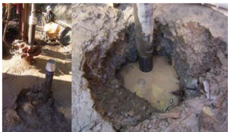
削孔状況(孔壁崩壊)
